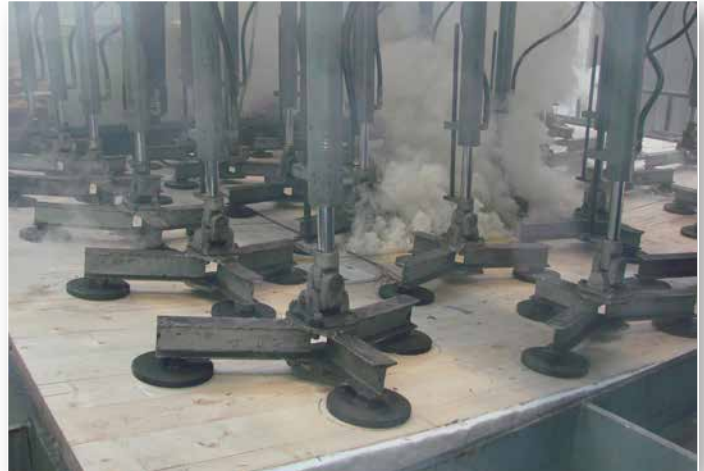
Le Conseil national de recherches du Canada (CNRC) est le principal organisme de recherche et développement au pays. Il doit procéder à des essais de résistance au feu sur les panneaux de bois lamellé-croisé (CLT). Photo utilisée avec l'autorisation du CNRC.
